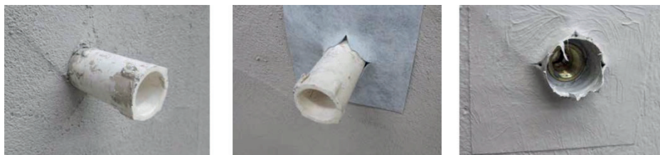
Fig. 29 –installazione non corretta di manicotti di rubinetteria
