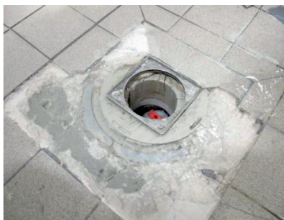
Fig. 26 – La flangia di tenuta è stata manomessa perché d'intralcio alla posa. Questo ha generato una mancanza di raccordo nella raccolta delle acque e di conseguenza ha generato infiltrazioni
